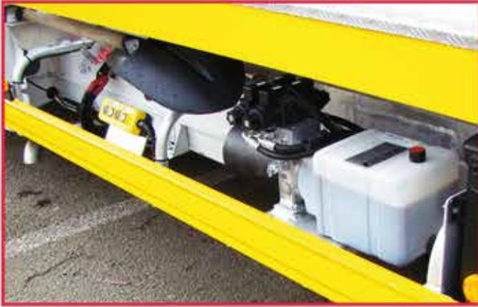
- Boîtier de contrôle avec groupe électropompe en version électrique.
